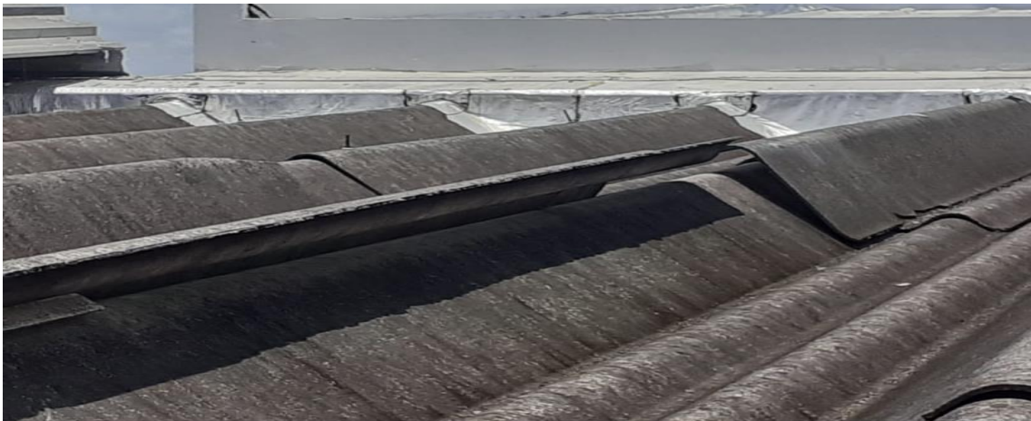
Imagem 21: Telha quebradas e algumas menores que o vão.
