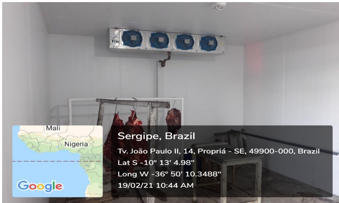
Imagem 47: Carnes armazenadas de forma incorreta.
