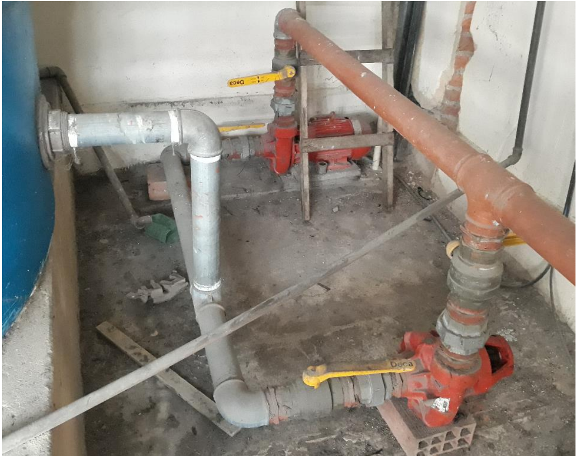
Imagem 46: Condição atual das bombas.
