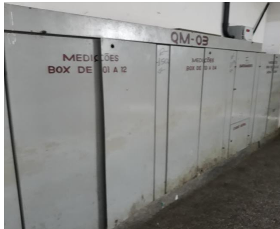
Imagem 25: Quadro de medição
