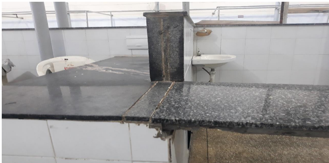
Imagem 13: Bancadas com diferentes tipos de granito e mal instalada.
