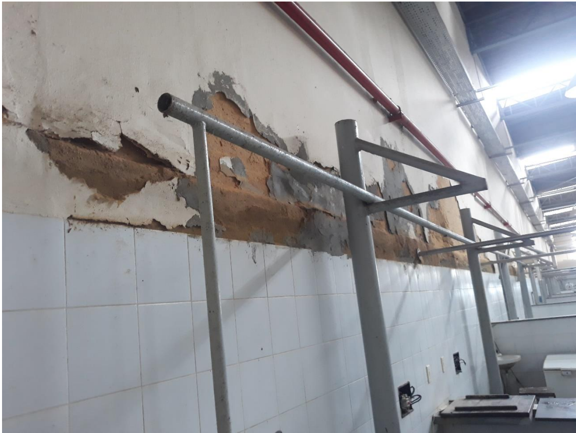
Imagem 44: Gancheira com sinais de corrosão
