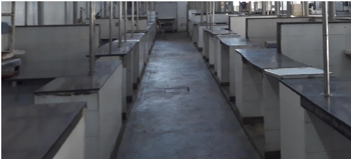
Imagem 32: Boxes sem portas de acesso e alguns com portas danificadas.
