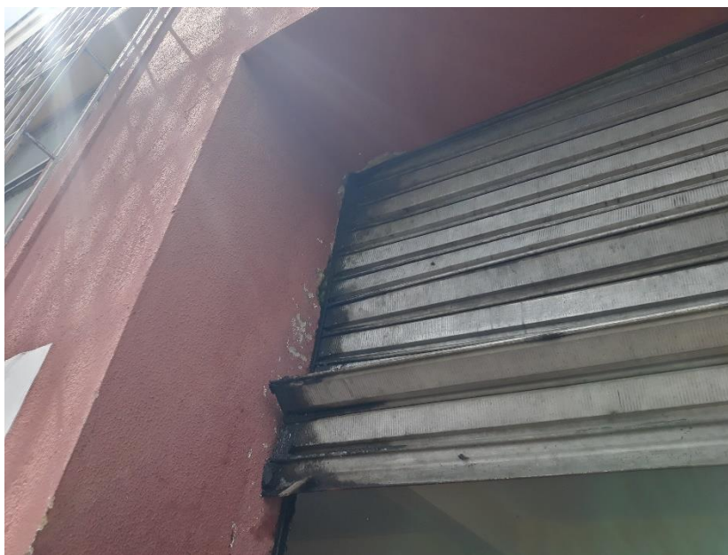
Imagem 33: Porta de enrolar danificada.
