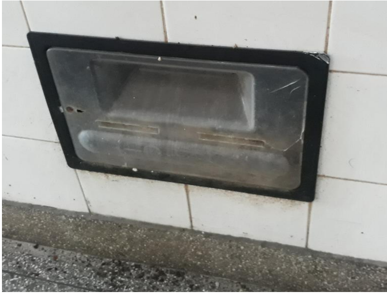
Imagem 19: Caixa de proteção fora dos padrões
