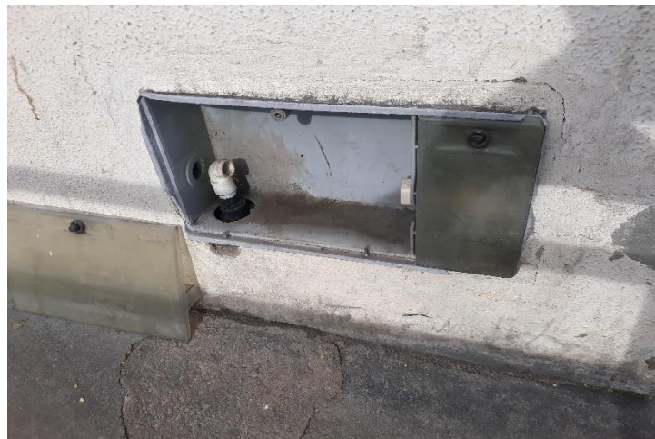
Imagem 16: Ausência do hidrômetro de entrada
