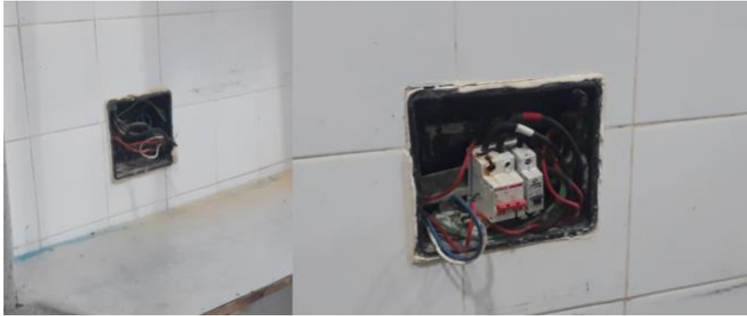
Imagem 27: Condição atual dos quadros e disjuntores.
